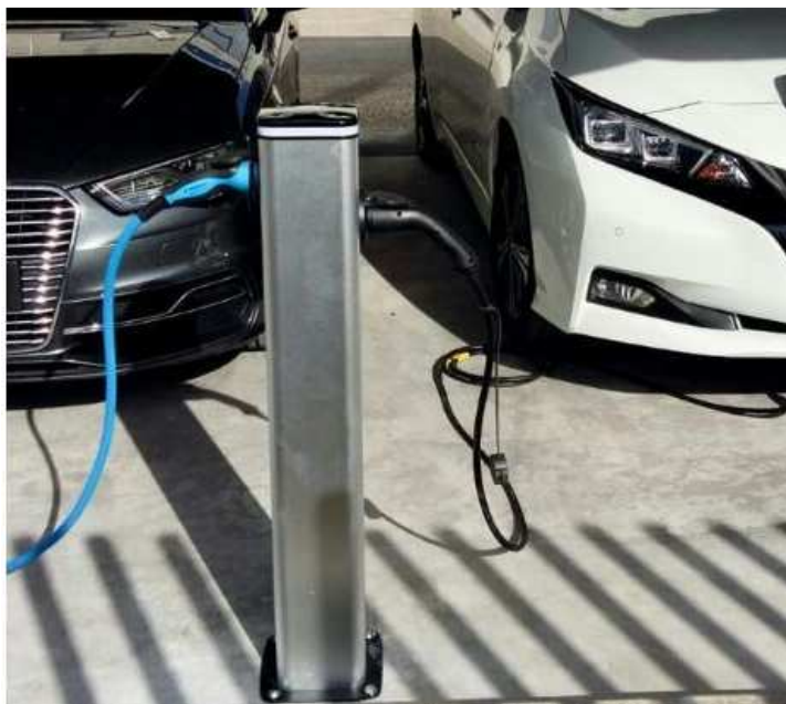
Obrázek 33 Nabíjecí sloupek pro nabíjení 2 vozidel 22kW s identifikací RFID čipem, TCP a OCPP, cena 50 000 Kč.
