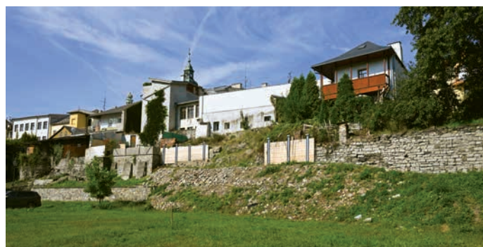
Zbytky hradeb nad Komenského ulicí, které se v roce 2023 částečně zřítily, jsou zatím nouzově zabezpečeny. Letos se zde chystají další práce. Foto: Petr Bakovský
